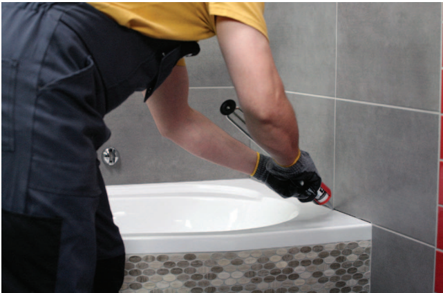
Połączenia urządzeń sanitarnych z okładziną należy wypełniać przy użyciu silikonu sanitarnego
